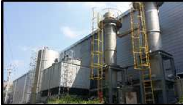
<열교환기 및 냉각탑 (응축수 발생)>
