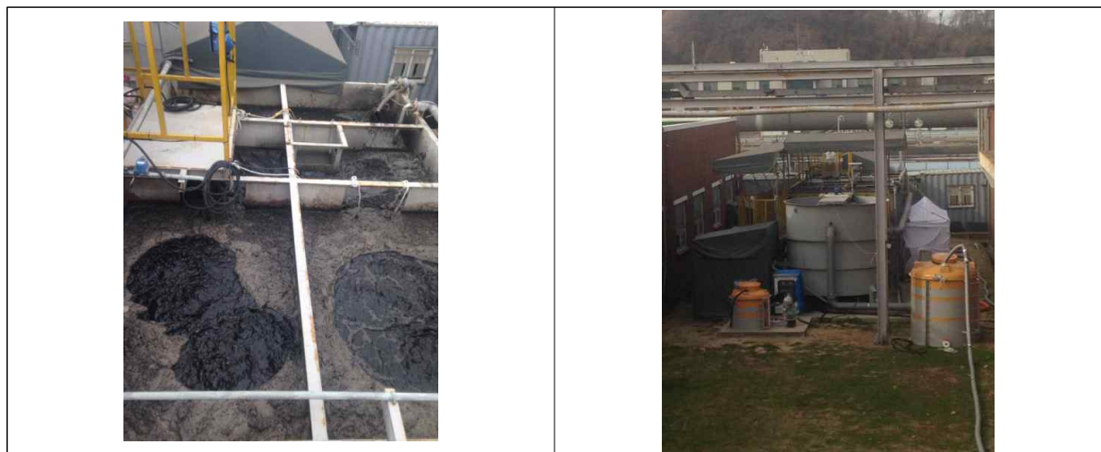
(그림 27) 안산 하수처리시설 내 Pilot Plant 전경(송풍기동 옆)
